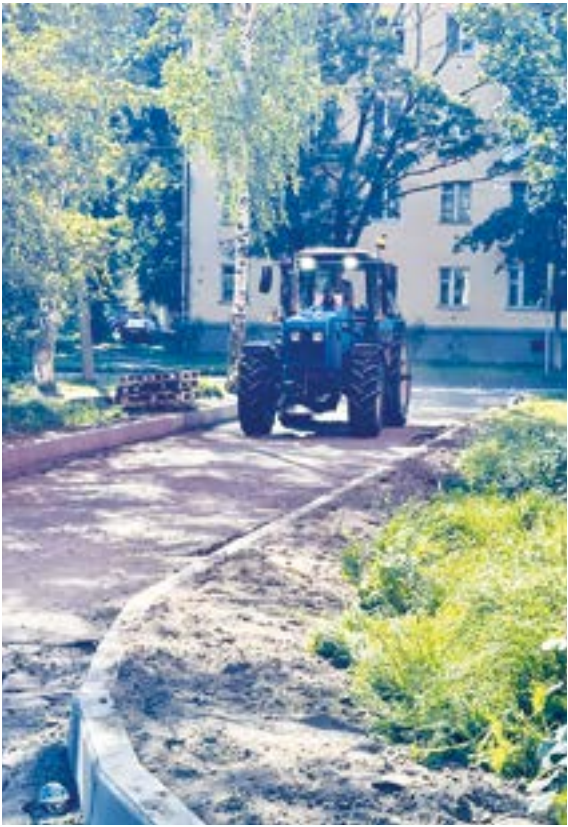
← Стоимость ремонта во дворах домов № 17 по улице Коммунаров и № 16 по улице Комсомольской превышает 3 млн рублей
